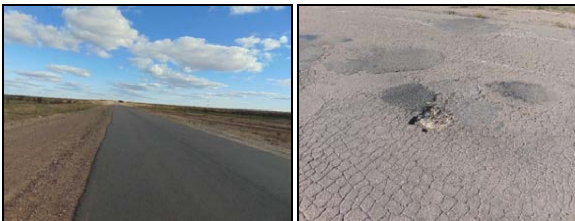
Figuras III.2.7. y III.2.8. Estado de la ruta en la proximidad al Parque Nacional donde se evidencian algunos arreglos parciales y nuevas roturas. Año 2018.
